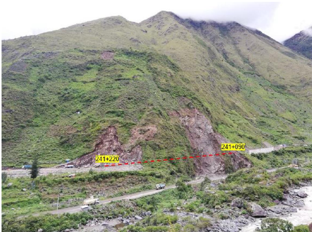
Figura 25 Vista panorámica del sector a evaluar geológica y geomecánicamente. Sub tramo Km 241+090 a 241+220.
