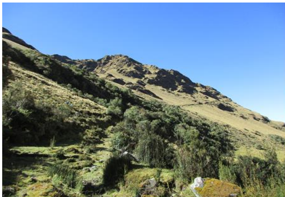
Figura 8. Afectaciones naturales en el camino en el empedrado del camino. Fuente: Autoría propia.
