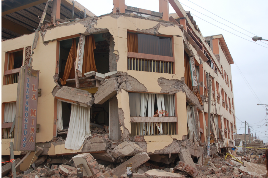
Figura 2.5: Edificaciones que fallaron en el sismo del año 2007. Fuente:[20]
