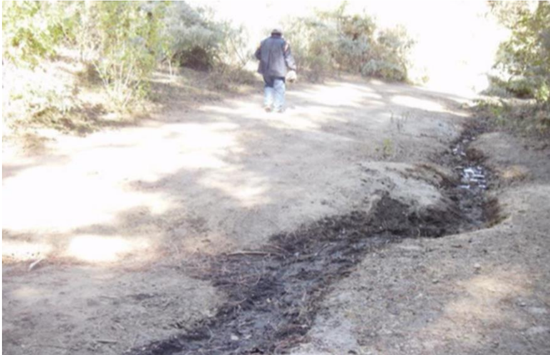
Ilustración 71: Servicios generales al sistema de abastecimiento de agua por manguera; de forma área y desnivel marcado en cruces de carretables y senderos presentando erosión y socavamiento, Fuente: Registro Fotográfico febrero 2016, Foto: Gonzalo A. Torres Z.
