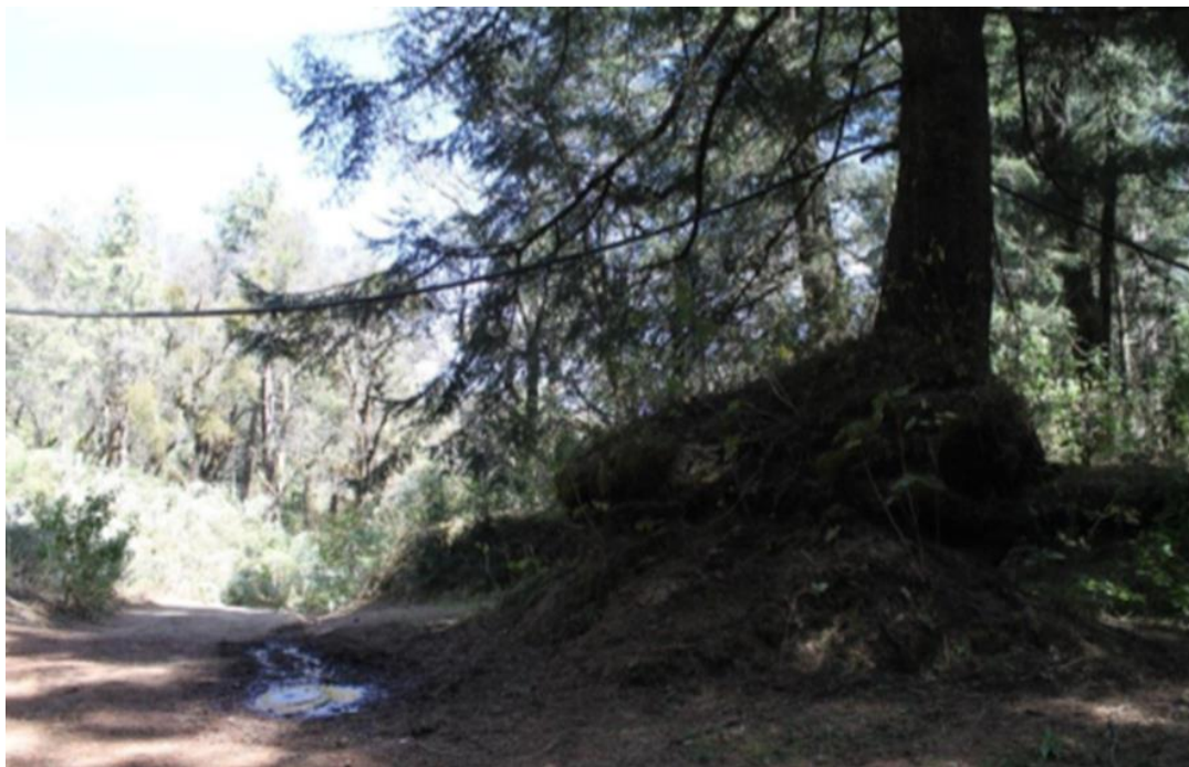
Ilustración 70: Servicios Generales Sistemas de Abastecimiento de Agua por manguera; deforma área y desnivel marcado en cruces de carreables y senderos presentado erosión y socavamiento, Fuente: Registro Fotográfico febrero 2016, Foto: Gonzalo A. Torres Z.
