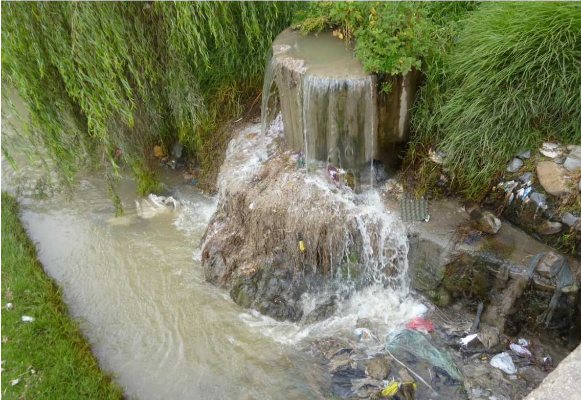
Figura 1. Red de Alcantarillado que Desemboca las Aguas Residuales al Río Chumbao - Andahuaylas.
