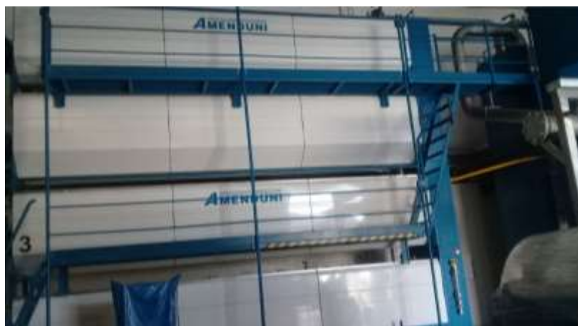
Figura 2.19 Batidora Horizontal. Centro de Producción S. Bartolomé, perteneciente a SCA Oleocampo de Torredelcampo, Jaén. (Fuente: Elaboración propia)
