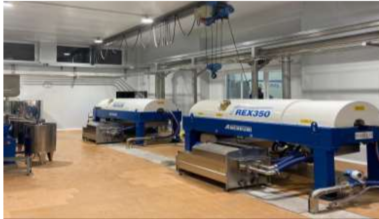
Figura 2.23 Decanter de 2 salidas. Centro de Producción Santa Catalina, perteneciente a SCA Oleocampo de Torredelcampo, Jaén. (Fuente: Elaboración propia )
