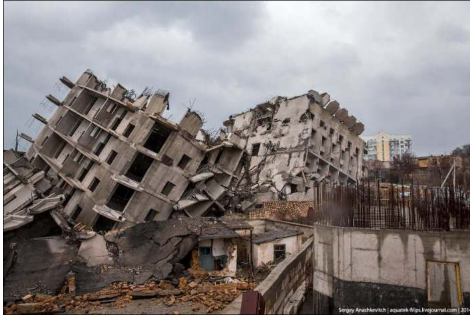
Рисунок 1.5 – Полное обрушение здания вследствие воздействия сейсмической нагрузки
