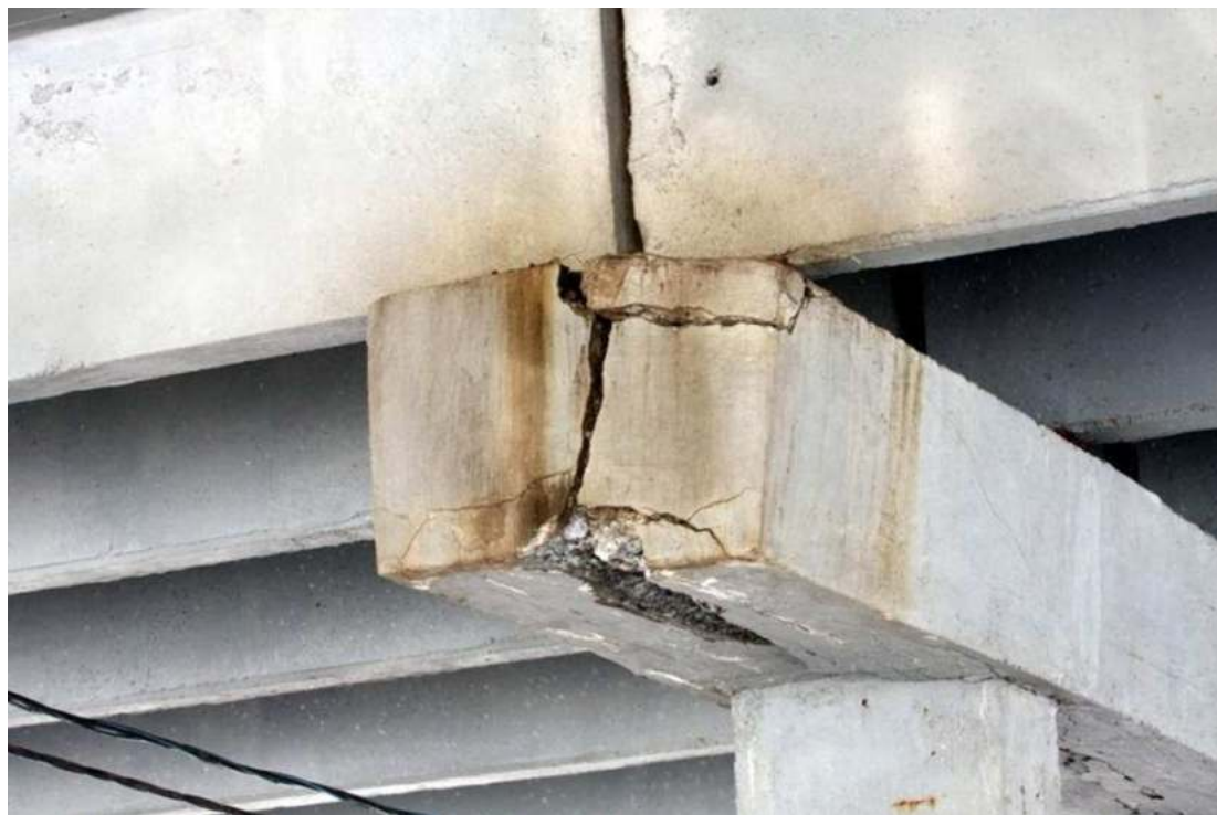
Рисунок 1.9 – Развитие трещины ригеля опоры эстакады
