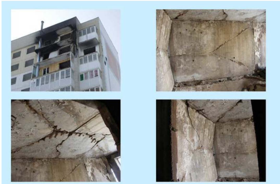
Рисунок 1.3 – Локальное разрушение стен многоквартирного жилого дома вследствие взрыва бытового газа
