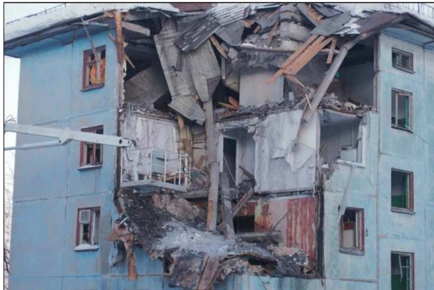
Рисунок 1.4 – Локальное разрушение стен многоквартирного жилого дома вследствие взрыва бытового газа
