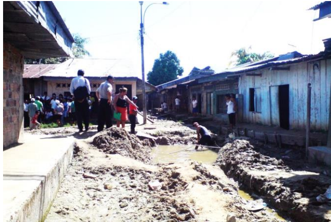
Imagen 160 Pavimentación colapsa a causa de malas infraestructuras
