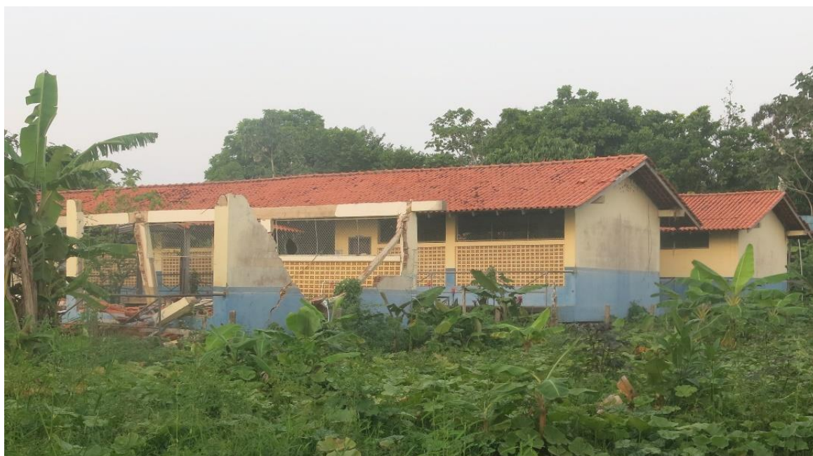
Figuras 56: Escombros do que foi uma das salas da Escola Municipal de Ensino Fundamental “Nossa Sra. do Livramento”, na comunidade quilombola de Saracura. Observe-se a construção de alvenaria inadequada a ambientes alagáveis. Fonte: Acervo pessoal.
