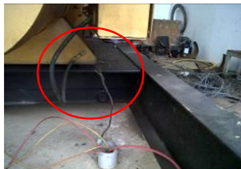
Figura 4.10. Generador de Emergencia.
