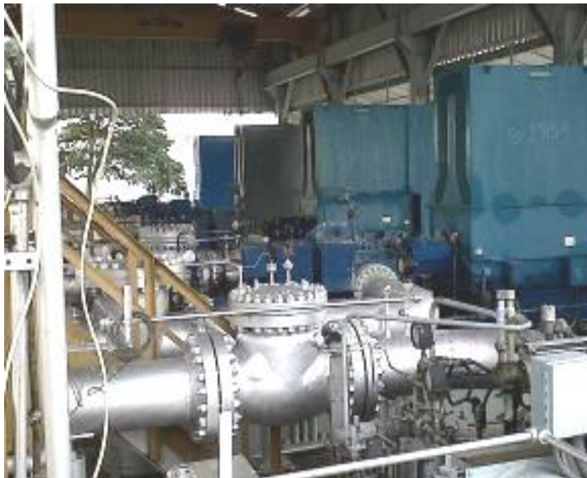
Figura 3.8 Sala de Bombeo Merrey
