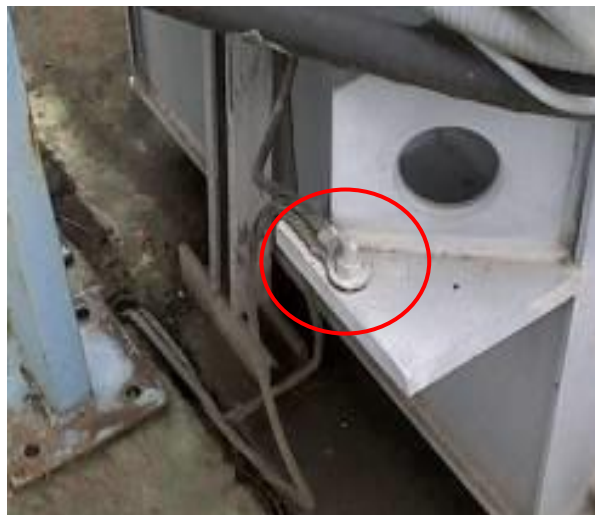
Figura 4.2. Puesta a Tierra del Transformador.
