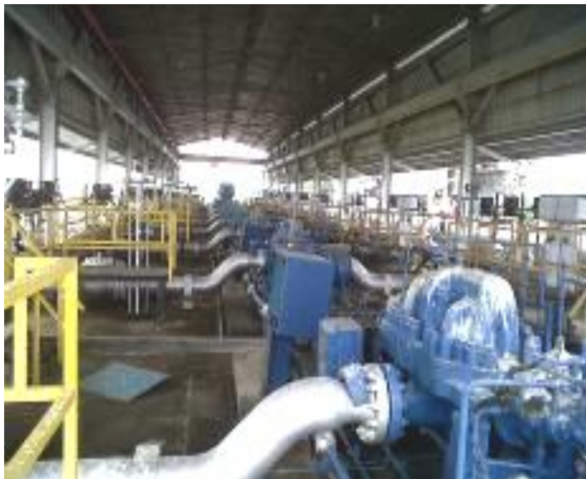
Figura 3.9 Sala de Bombeo Mesa
