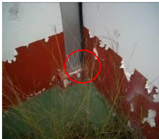
Figura 4.21. Llegada a la Puesta a Tierra.
