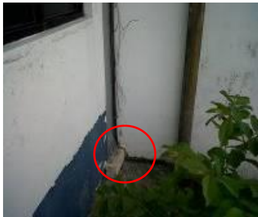
Figura 4.19. Llegada a la Puesta a Tierra.
