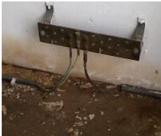
Figura 4.11. Barra Equipotencial de Puesta a Tierra.
