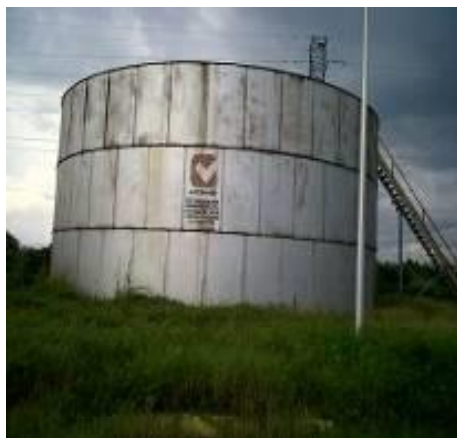
a) Tanque 1 SCI
