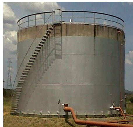
b) Tanque 2 SCI
