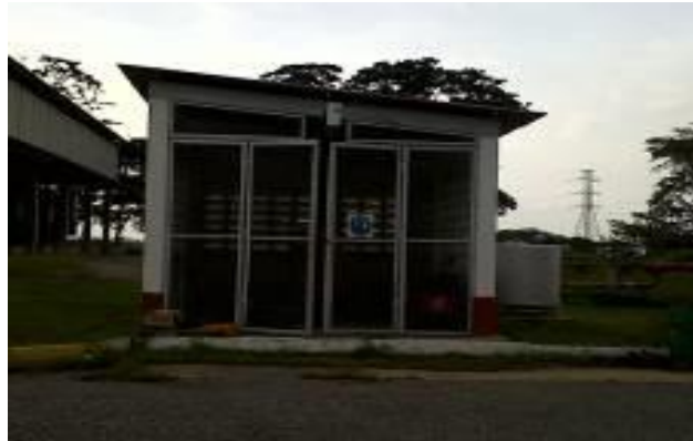
Figura 4.31. Caseta del Generador del Emergencia.
