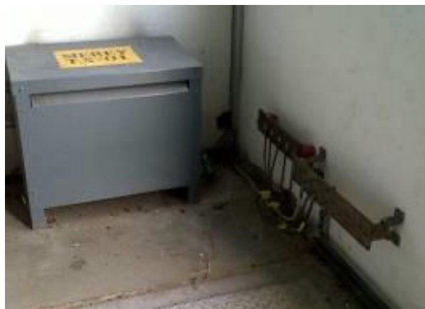
Figura 4.4. Barras de Puesta a Tierra Caseta de arrancadores Merrey.
