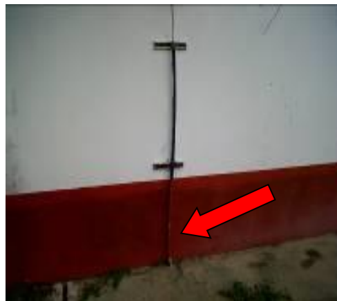
Figura 4.14 Bajada a la Puesta a Tierra.
