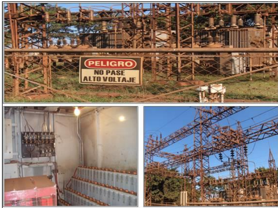
Figura 17. Parte Superior: Transformadores contaminados con PCB. Inferior Izquierda: Banco de Baterías de Níquel-Cadmio. Inferior Derecha: Torres de alta tensión de la sub-estación.
