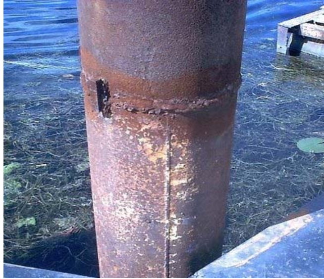
Fig. 2.15. Corrosión salina. (Perry, 1998)
