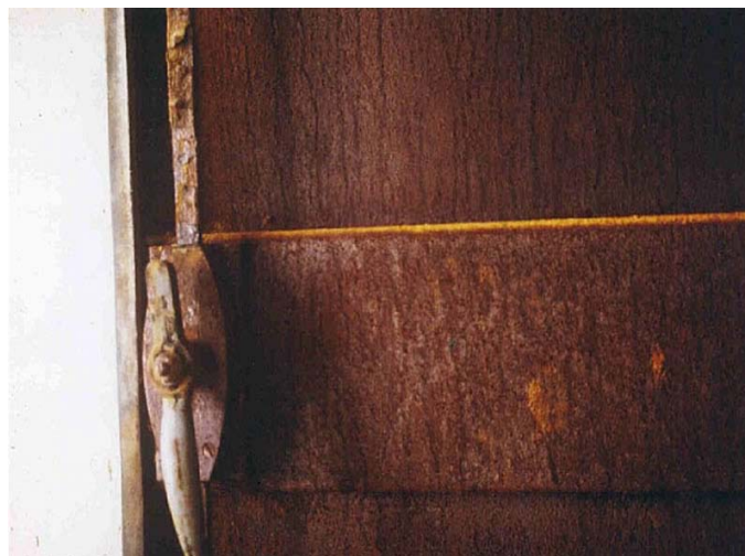
Fig. 2.8. Corrosión Uniforme. Laboratorio de Físico-química de la empresa INSA.
