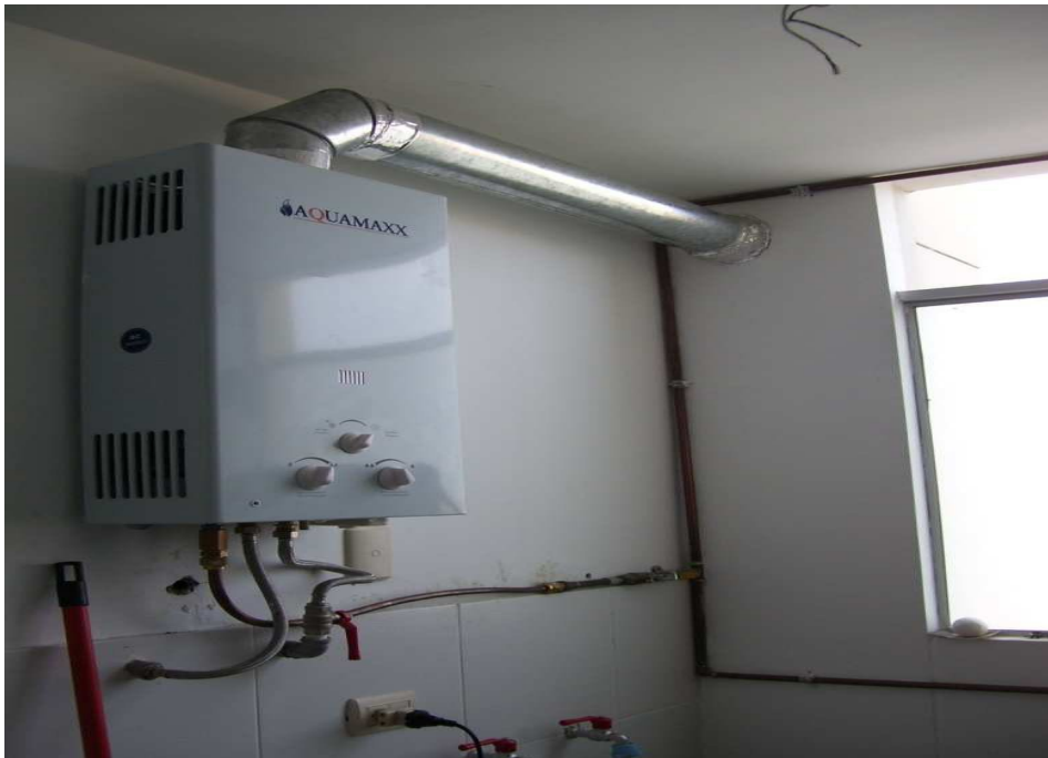
Figura 16. Ducto de ventilación de terma
