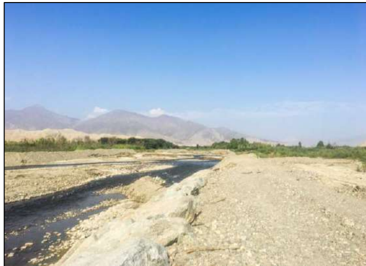
FOTO 19. DIQUES DE TIERRA EROSIONADOS POR LAS CRECIDAS DEL AÑO 2018. FOTO: CÉSAR ABAD PÉREZ, 2018
