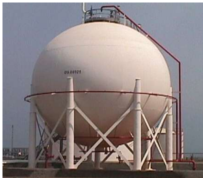
Figura 4.8. Sistema de diluvio en las esferas de propano.
