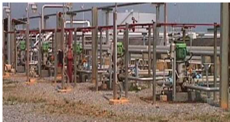
Figura 4.4. Bombas de carga de propano.
