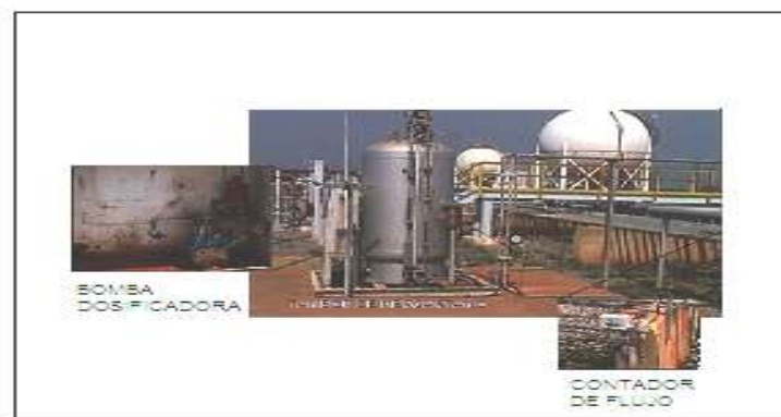
Figura 4.7. Sistema de odorización.
