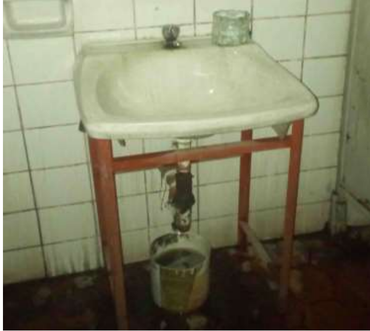
Fotografía 08, Peligros biológicos en Taller de Mantenimiento.
