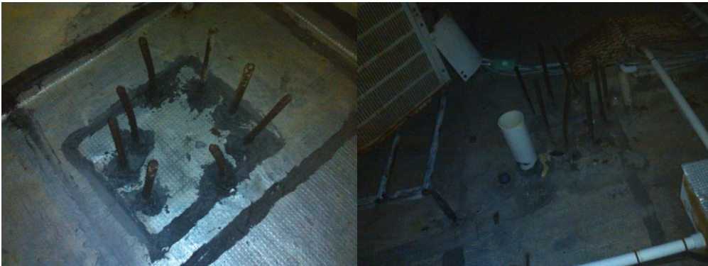
21.- Aspecto de lo encontrado en el techo, el refuerzo y la impermeabilización.
