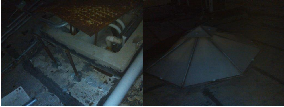
22.- Situaciones encontradas en el techo del edificio.
