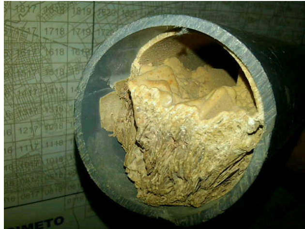
FIGURA 4.21. TUBERÍA DE PVC CON INCRUSTACIONES, D = 75 mm. RED DE DISTRIBUCIÓN EL MANZANO, DIEZ AÑOS EN SERVICIO.
