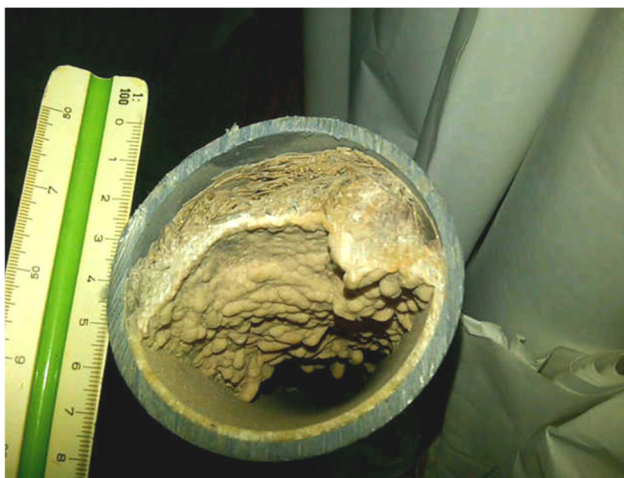
FIGURA 4.20. TUBERÍA DE PVC CON INCRUSTACIONES, D = 75 mm. RED DE DISTRIBUCIÓN EL MANZANO, DIEZ AÑOS EN SERVICIO.
