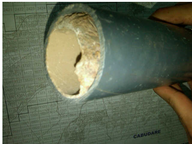
FIGURA 4.22. TUBERÍA DE PVC CON INCRUSTACIONES, D = 75 mm. RED DE DISTRIBUCIÓN EL MANZANO, DIEZ AÑOS EN SERVICIO.
