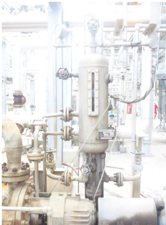
Figura 4.16. Reservorio y tuberías del plan API 52 de la bomba G-2005A.
