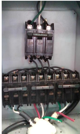
Ilustración 94 Caja principal de interruptores del conjunto de máquinas bobinadoras.
