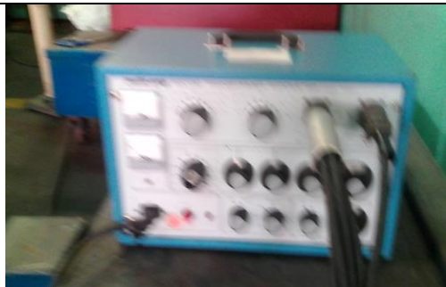
Ilustración 42 TTR Trifásico usado para corroborar la relación de transformación. Fuente: El autor.
