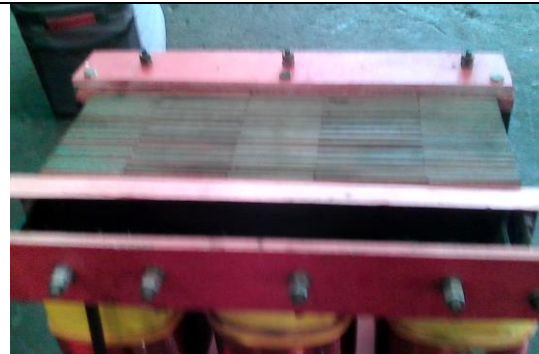
Ilustración 39 Transformador trifásico fabricado. Fuente: El autor.
