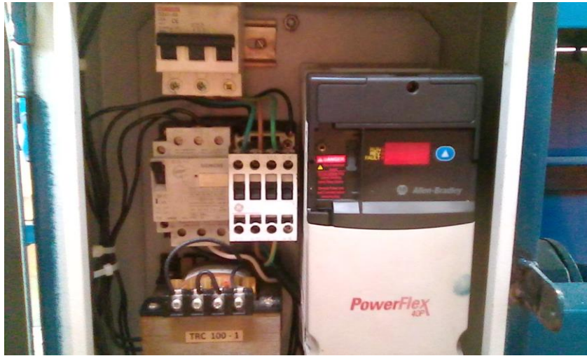
Ilustración 93 Variador de frecuencia PowerFlex 40P.
