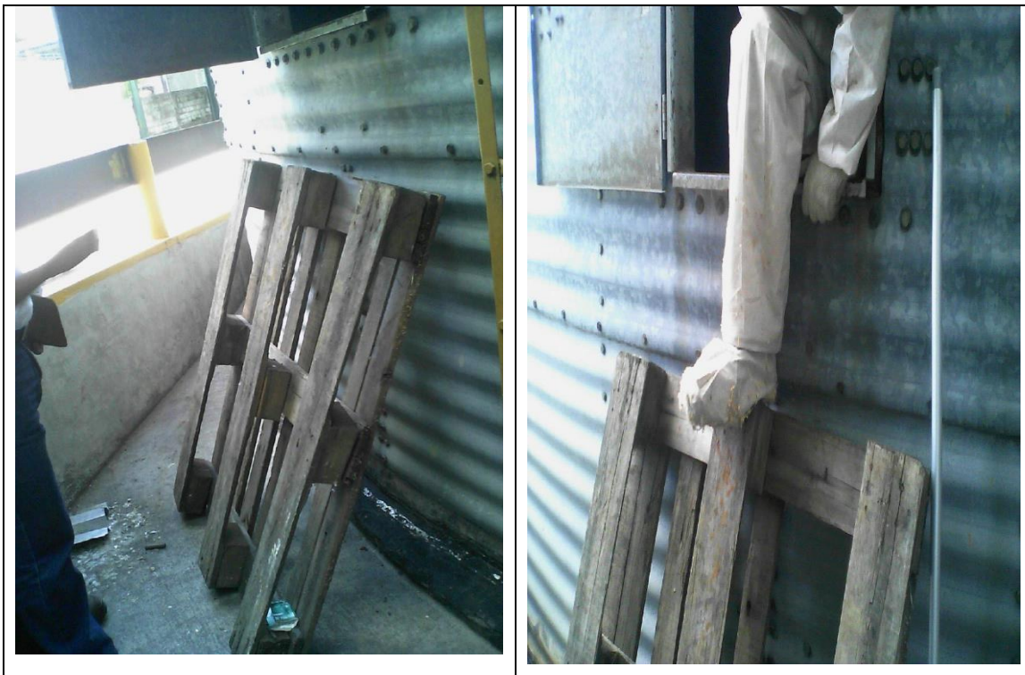
Mecanismo que utilizan actualmente los trabajadores para ingresar en los silos pequeños
