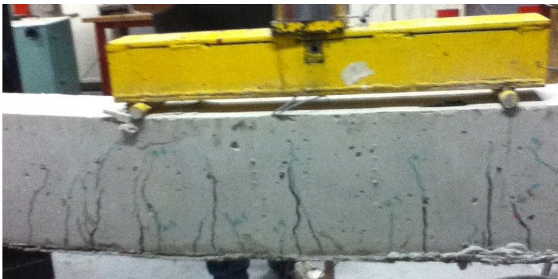
Photo. 2.15. Distribution des fissures de la Poutre renforce par 2 Couches de TRC (P1)
