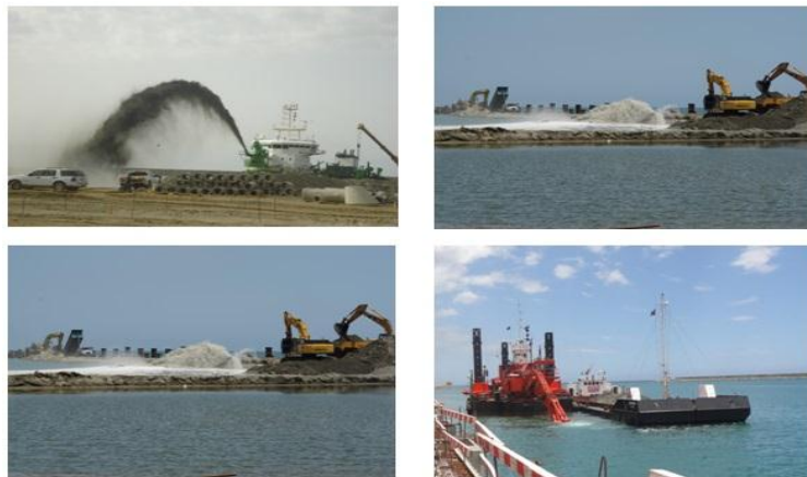
Figura 10. Preparación del sector oeste para la etapa de hincado de pilotes. Fuente: Fases de Ejecución. Bolipuertos (2014).
