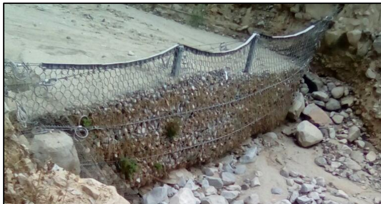
Barrière flexible # 3 dans le torrent Pedregal SOURCE : Autorité National de l'Eau du Pérou (ANA), 2018
