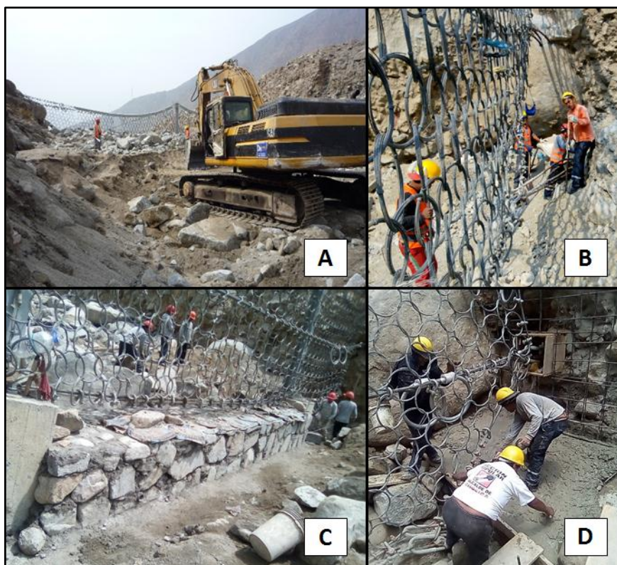
Figure 38. Travaux de nettoyage et de renforcement des barrières à Chosica, (A) Nettoyage de la barrière # 15 (torrent Quirio) avec une pelleteuse (B) Nettoyage manuel de la barrière # 20 (torrent La Ronda) avec des outils (C) Construction d'un mur de béton à la base de la barrière # 4 (torrent Pedregal) (D) Construction d'un mur de béton armé aux extrémités de la barrière # 17 (torrent Santo Domingo)
