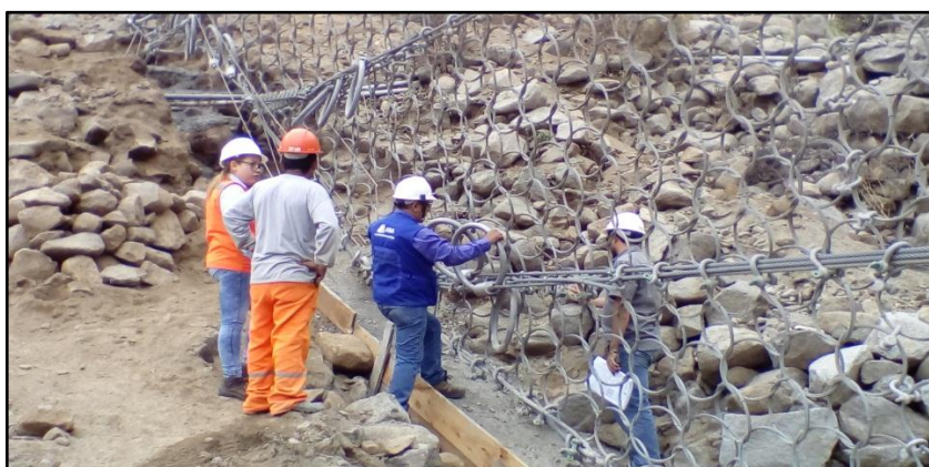
Figure 39. Actions de surveillance de l'ANA au niveau de la barrière #13 du torrent La Libertad,
