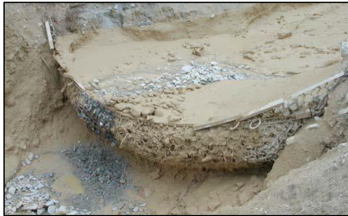
Figure 25. Premier modèle à échelle 1:1 d'une barrière flexible pour faire face aux laves torrentielles en 2005 dans le torrent Illgraben (Suisse)
