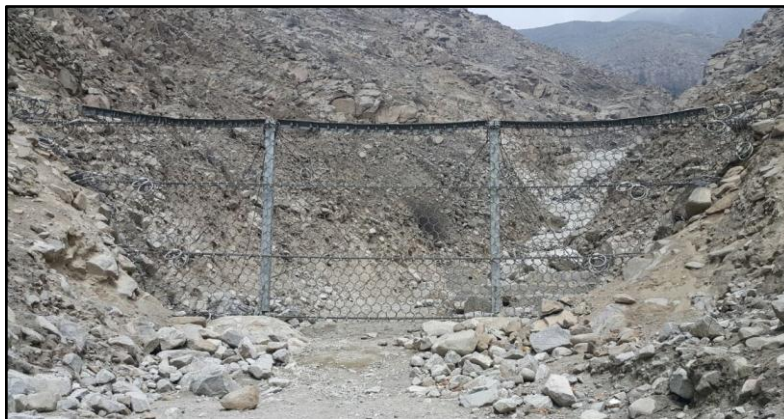
Figure 9. Barrera Dinámica installée dans le torrent La Libertad à la fin de l'année 2015
