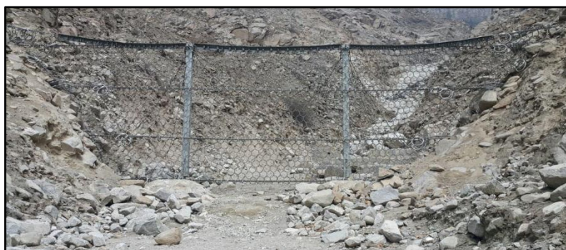
Figure 32. Barrière flexible # 13 dans le torrent La Libertad à Chosica (barrière type UX avec 2 supports intermédiaires)
