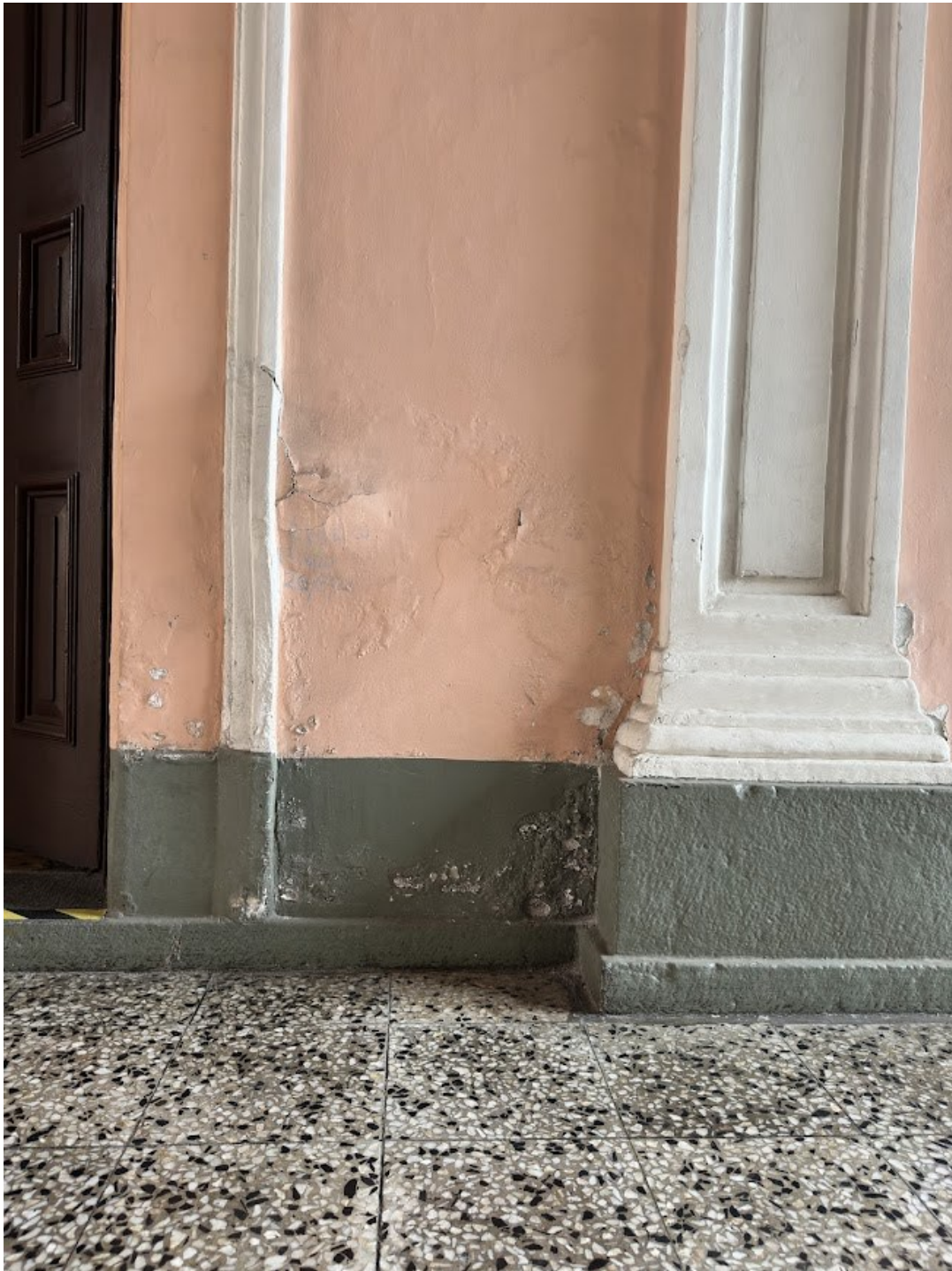
Imagen 106. Presencia de humedad, ampollas y fisuras en reflejo del soporte. Fuente: Fotografía propia.
