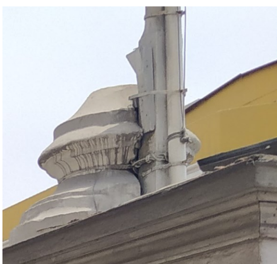
Imagen 103. Ennegrecimiento, desprendimiento de revoque.
