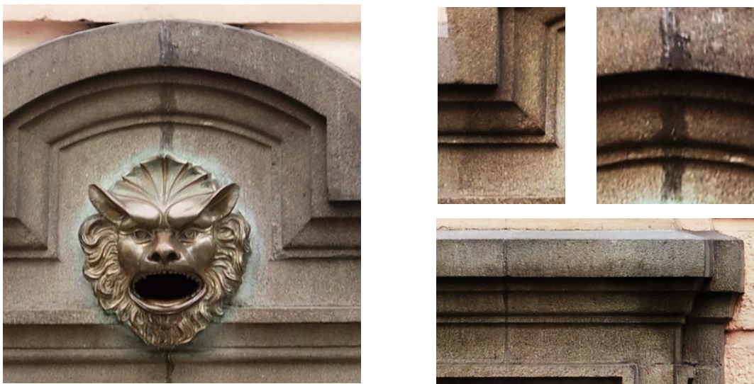
Imagen 88. Decoloración y manchas por humedad. Fuente: Archivo PROLIMA.
