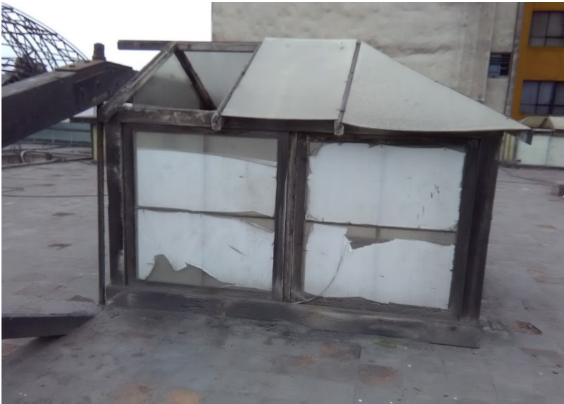
Imagen 126. Perdida de vidrios en la linterna. Fuente: Fotografía del autor.
