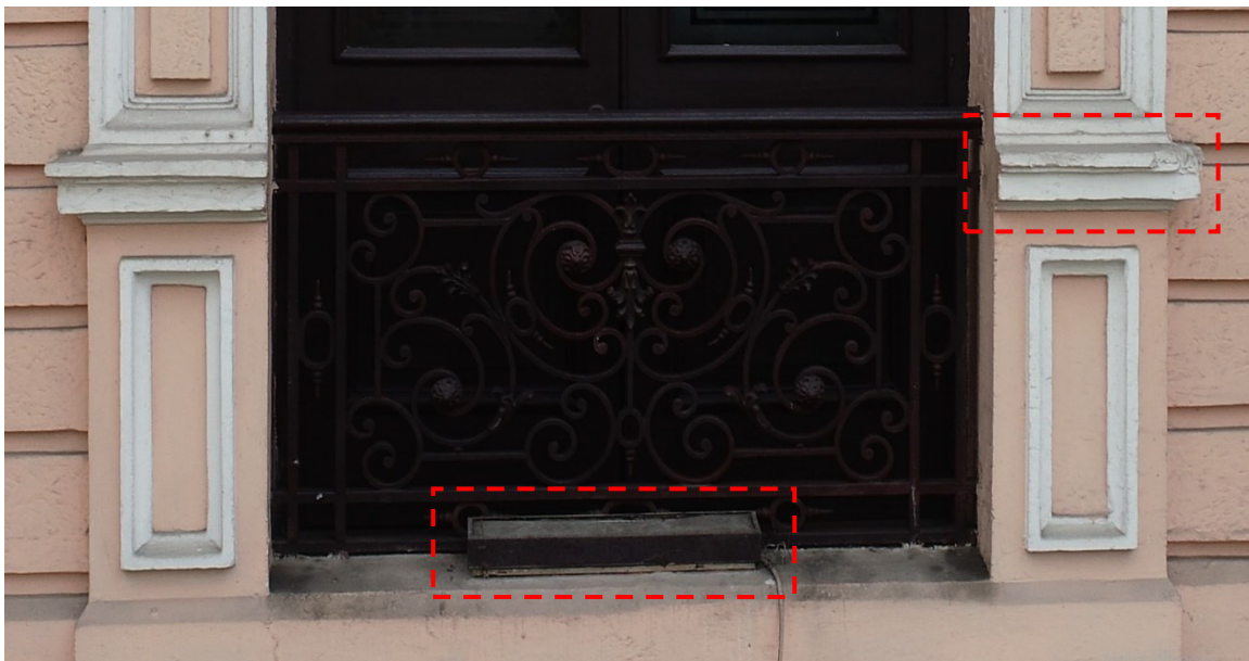
Imagen 100. Ennegrecimiento, elementos incompatibles, oxidación en parapeto de forja, pérdida de molduras de yeso.
