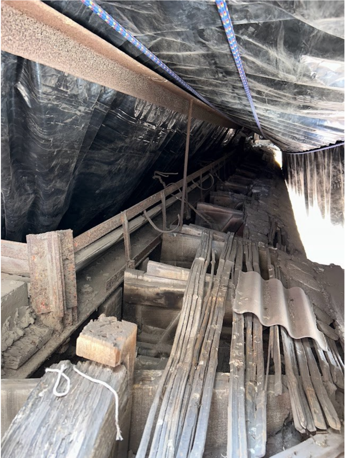
Imagen 129. Pérdida de masa y caña partida del muro que une la fase 1 y la fase 2. Fuente: Fotografía del autor.
