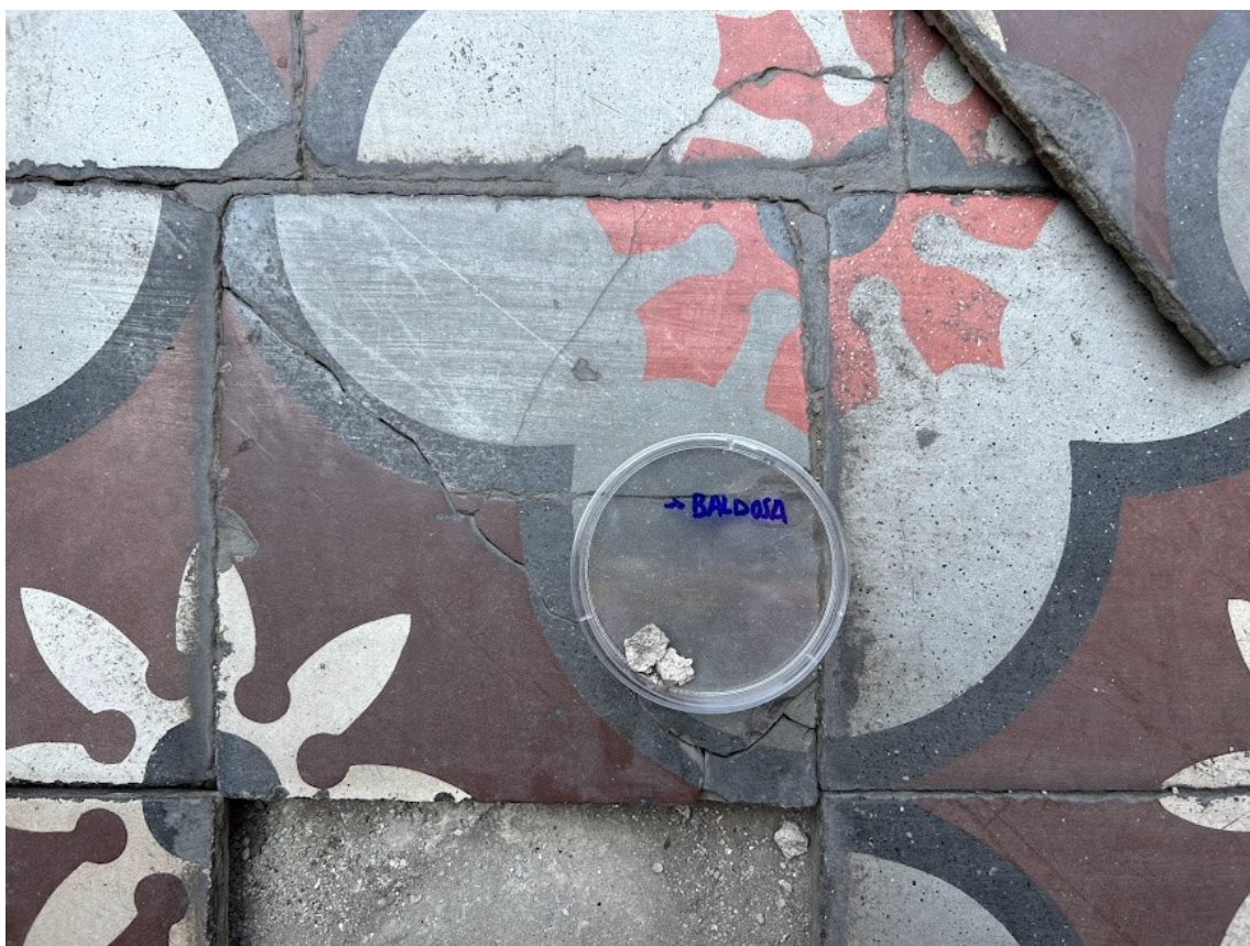
Imagen 31. Baldosa del segundo nivel, junto con muestra extraída in situ. Fuente: Fotografía propia.
