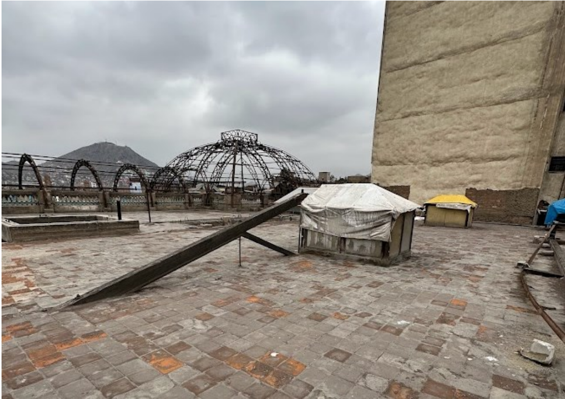
Imagen 125. Vista del techo, pérdida de masa de los ladrillos pasteleros. Fuente: Fotografía del autor.
