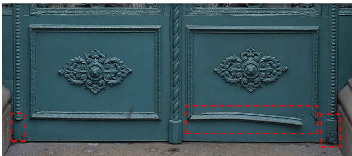
Imagen 96. Ennegrecimiento, pérdida de elementos y oxidación.
