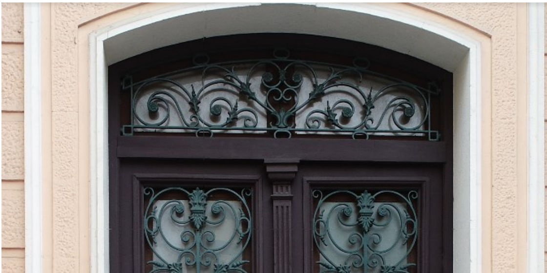
Imagen 94: Ennegrecimiento, oxidación en sobre luz de forja y sus elementos, xilófagos en elementos de madera, intervención incompatible en vidrios.
