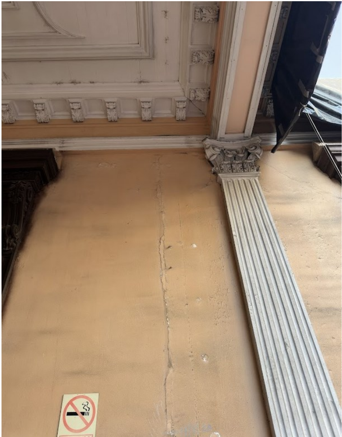
Imagen 115. Fisuras reflejo del soporte de espacio previo al salón. Fuente: Fotografía del autor.
