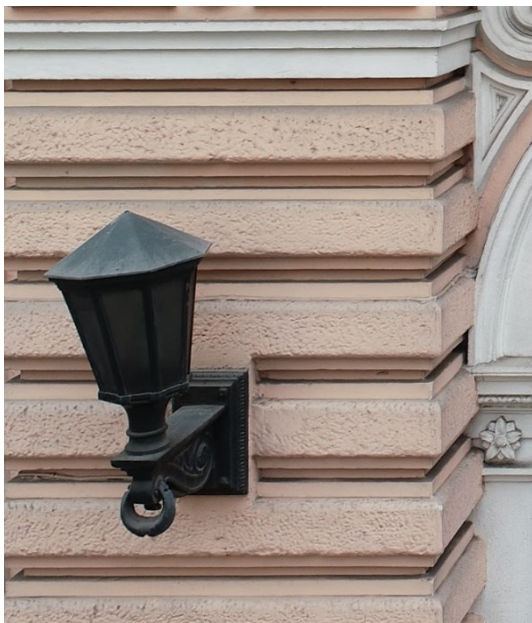
Imagen 91. Ennegrecimiento e irregularidades por resane y repintes
