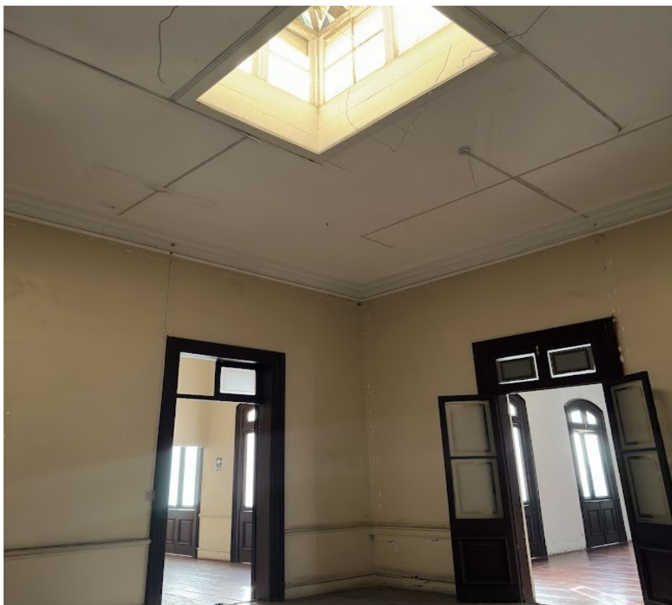
Imagen 121. Espacio intermedio, pérdida de zócalo, incompatibilidad de luminarias y de piso. Fuente: Fotografía del autor.
