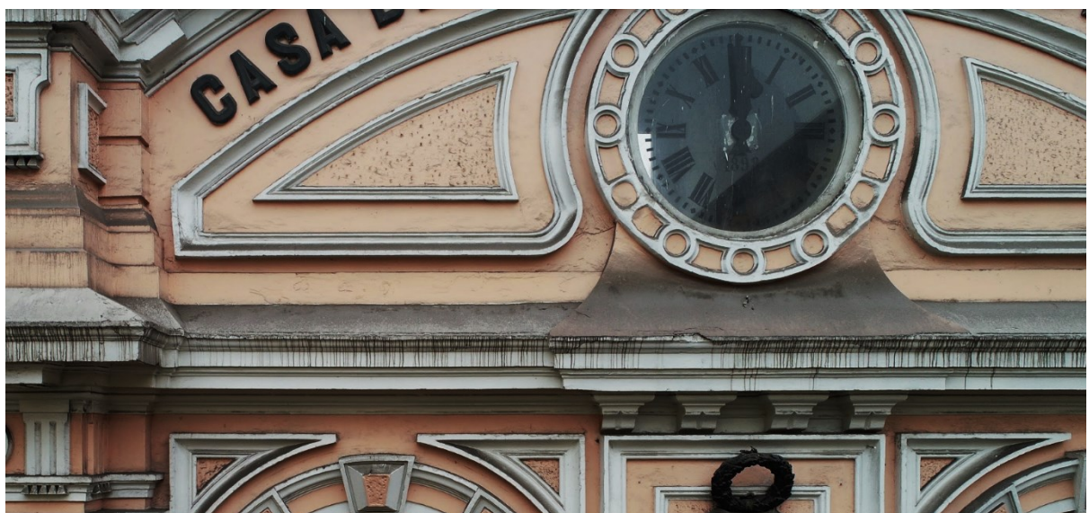
Imagen 97. Ennegrecimiento, manchas por depósito, fisuras, ampollas, pérdida de masa por desprendimiento de revoque en elementos de yeso.
