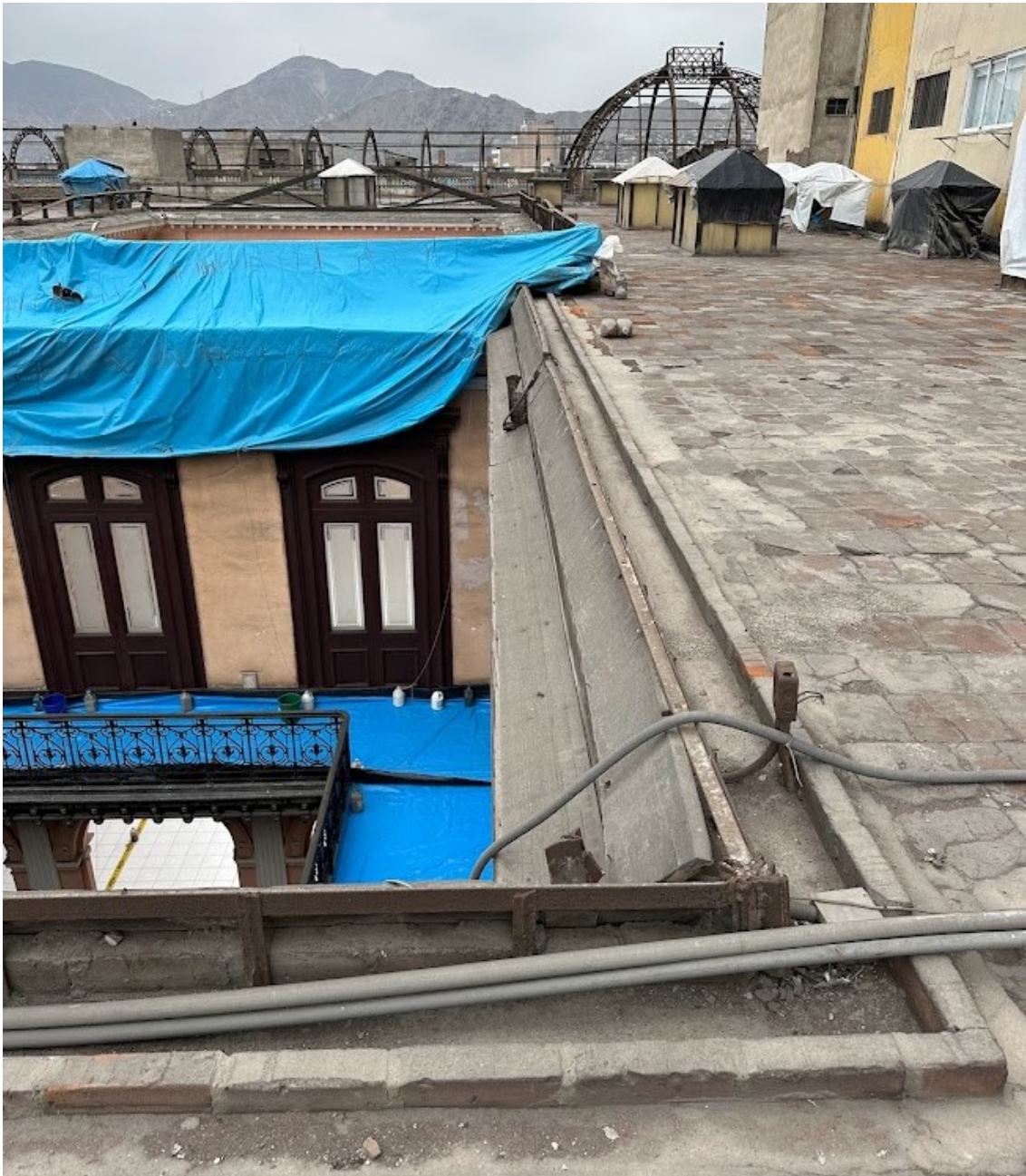
Imagen 127. Cables expuestos en las cornisas. Fuente: Fotografía del autor.
