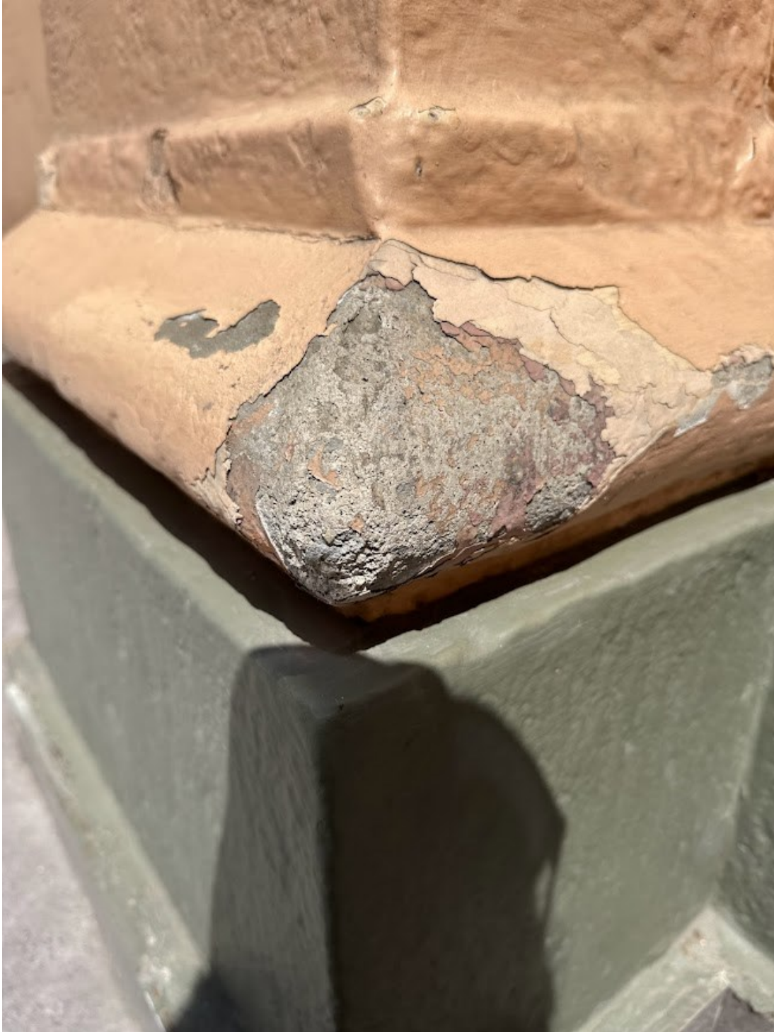
Imagen 113. Decoloración y pérdida de la capa pictórica de pilastra del primer nivel del patio de vianderas. Fuente: Fotografía del autor.
