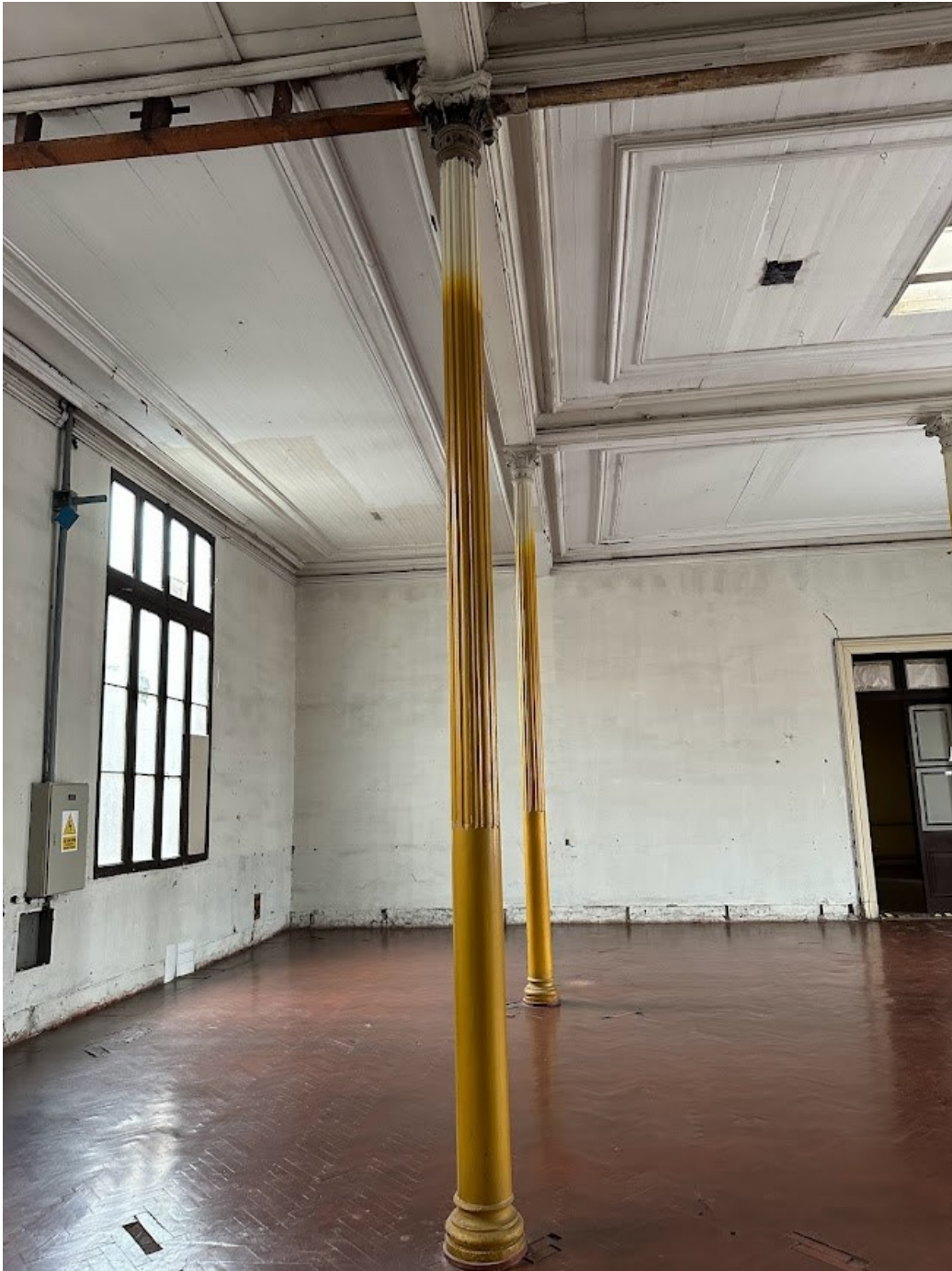
Imagen 122. Perdida del entablado, del enfoscado del muro de quincha. Fuente: Fotografía del autor.
