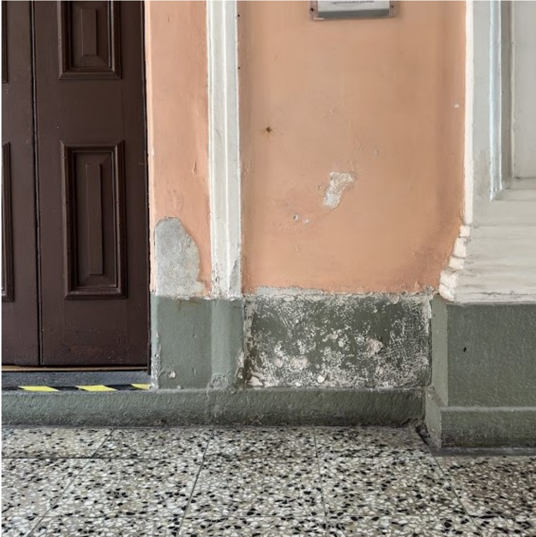
Imagen 107. Presencia de humedad, ampollas y fisuras en reflejo del soporte. Fuente: Fotografía propia.
