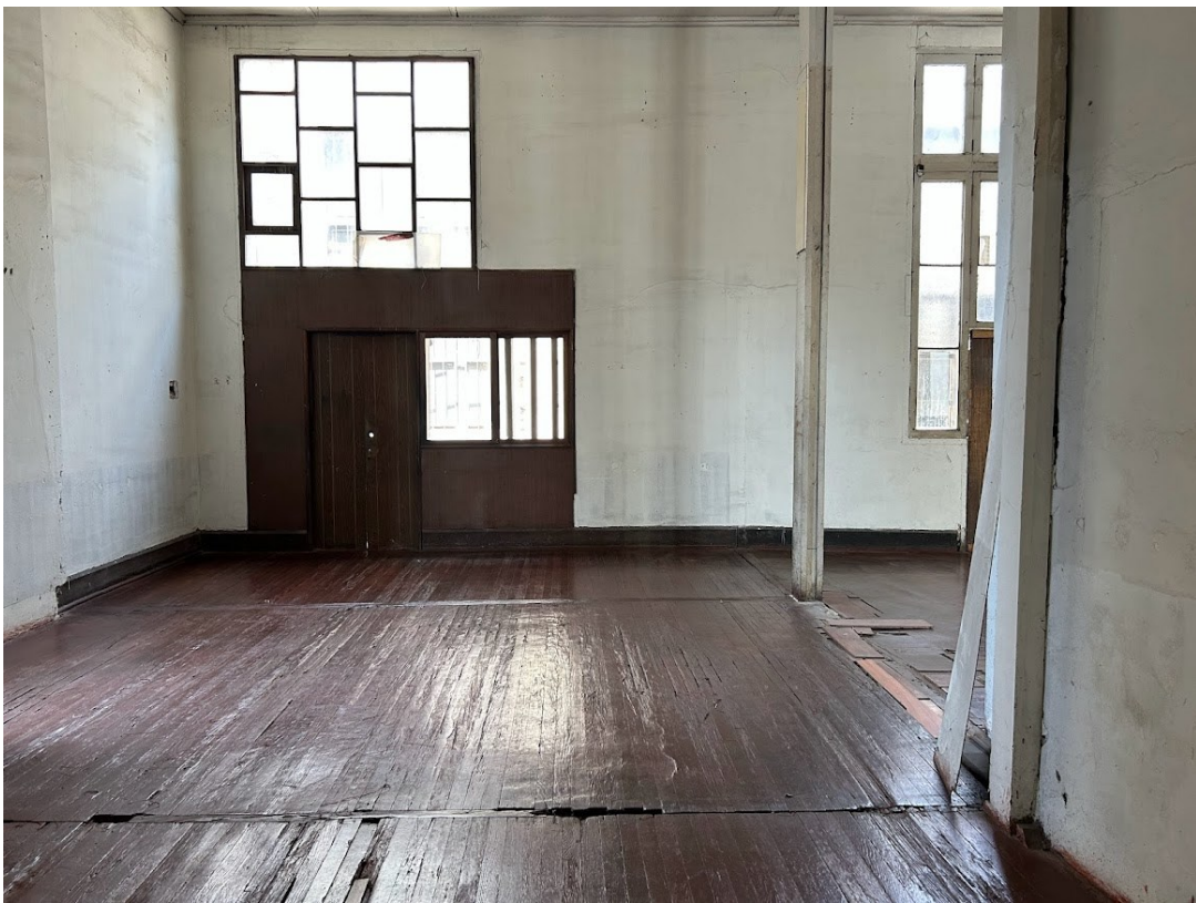
Imagen 119. Perdida del entablado, del enfoscado del muro de quincha. Fuente: Fotografía del autor.
