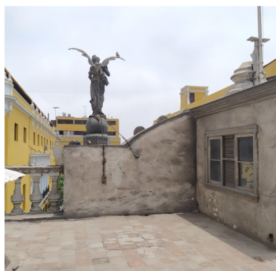
Imagen 102. Ennegrecimiento, manchas por depósito, craquelación, pérdida de capa pictórica, desprendimiento de revoque, cableado expuesto y desprendimiento de revoque en pasamanos de ladrillo revestido en yeso.
