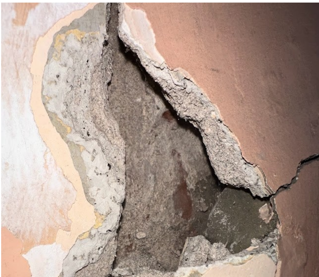
Imagen 17. Fisura del Hall de ingreso en primer nivel. Se puede observar el ladrillo y las capas de revoque y enfoscado. Fuente: Imagen propia.
