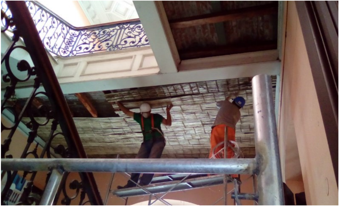
Imagen 61. Restitución de la caña partida. Arquitecto Sosa Valle, M. (2018, 20 de febrero). Proyecto de Emergencia en la Casa de Correos y Telégrafos - Área de Intervención
