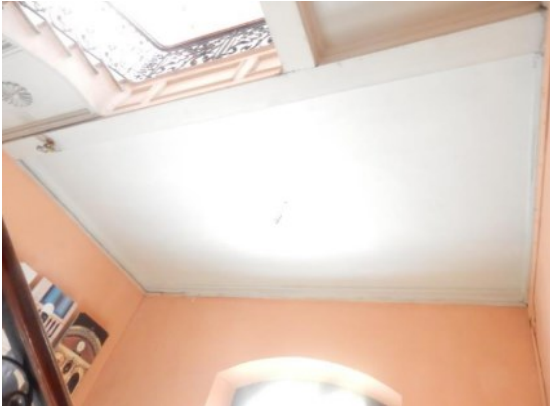
Imagen 63.Resultado final. Arquitecto Sosa Valle, M. (2018, 20 de febrero). Proyecto de Emergencia en la Casa de Correos y Telégrafos - Área de Intervención.
