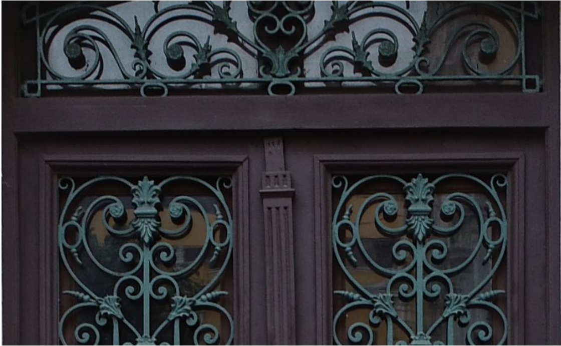
Imagen 93. Ennegrecimiento oxidación en sobre luz de forja y sus elementos, xilófagos en elementos de madera. Fuente: Archivo PROLIMA.
