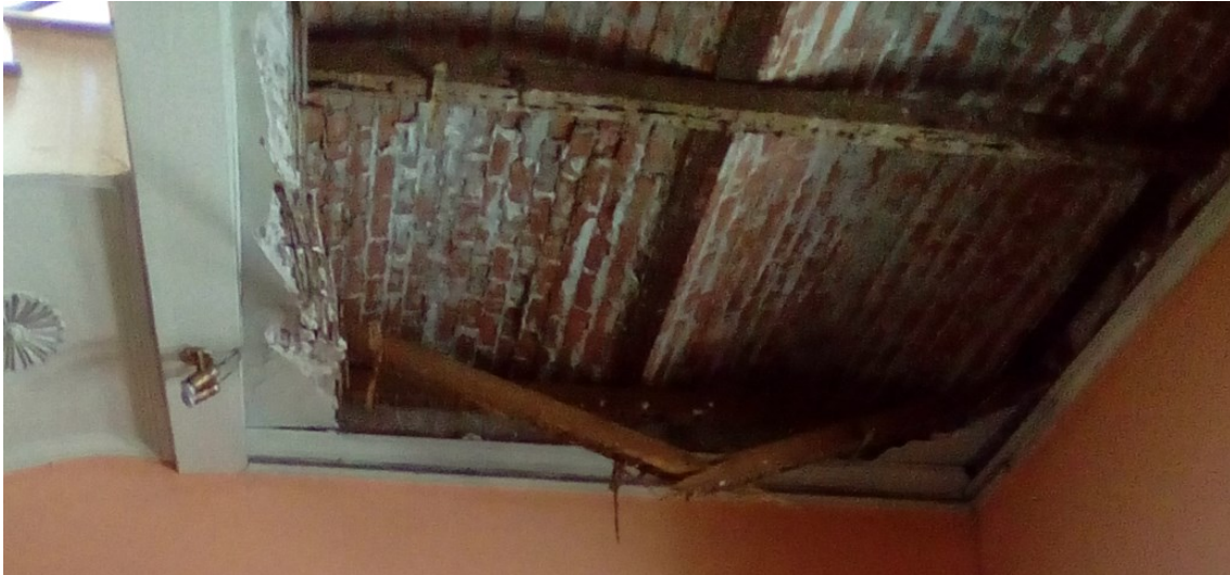
Imagen 28. Fotografía del desplome del cielo raso. Fuente: Arquitecto Sosa Valle, M. (2018, 20 de febrero). Fuente: Proyecto de Emergencia en la Casa de Correos y Telégrafos - Área de Intervención.
