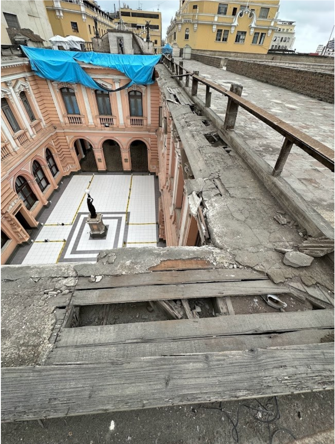
Imagen 128. Pérdida de masa en las cornisas del patio de las vianderas. Fuente: Fotografía del autor.
