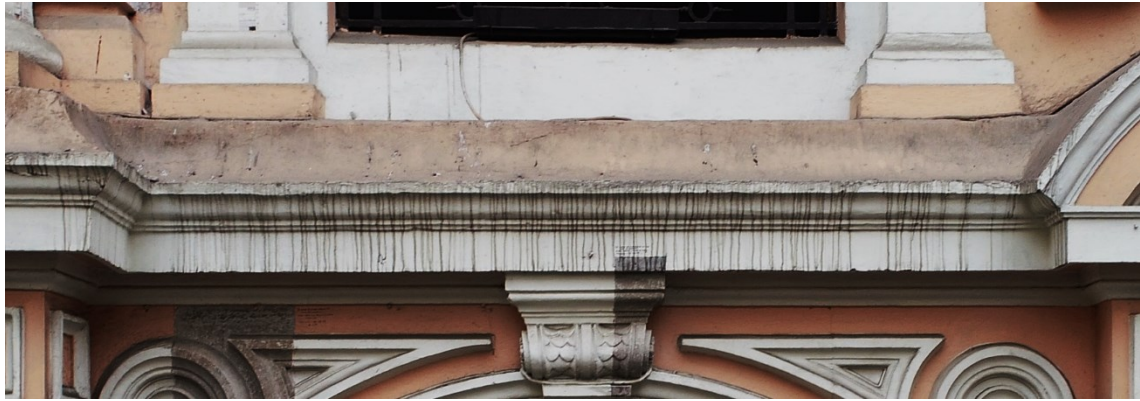
Imagen 89. Ennegrecimiento, manchas por depósito. Fuente: Fotografía del autor.
