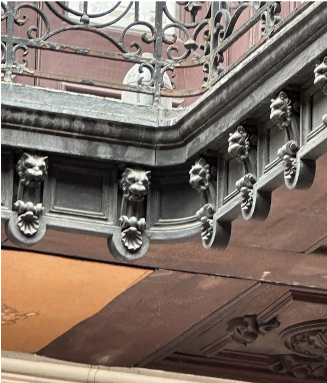
Imagen 112. Pérdida del artesonado del voladizo del zaguán. Fuente: Fotografía del autor.
