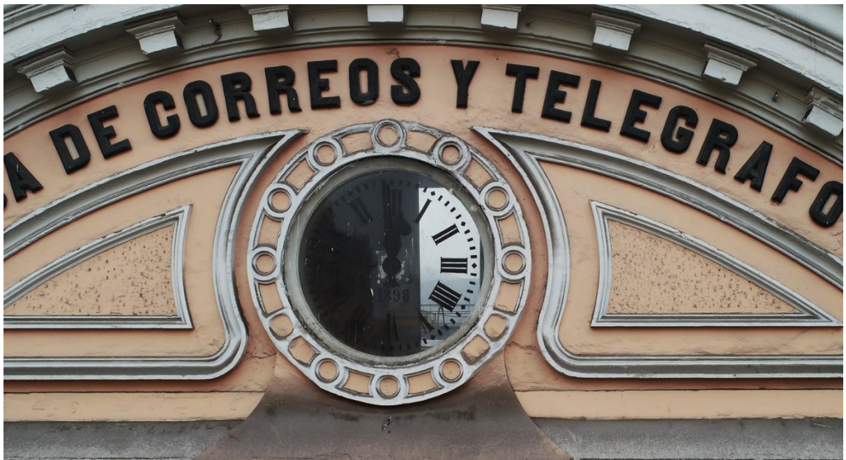
Imagen 98. Ennegrecimiento, manchas por depósito, fisuras, ampollas, pérdida de masa por desprendimiento de revoque en elementos de yeso.
