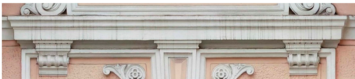
Imagen 92. Ennegrecimiento, manchas por depósito y cableado expuesto. Fuente: Archivo PROLIMA.
