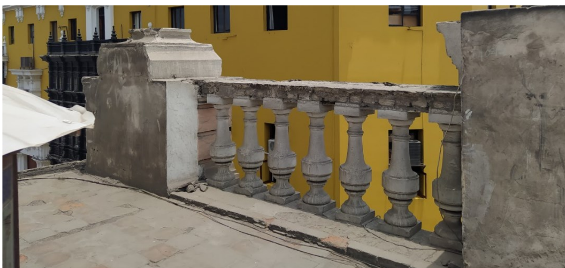
Imagen 101. Ennegrecimiento, craquelación, pérdida de capa pictórica, desprendimiento de revoque en pasamanos de ladrillo revestido en yeso.
