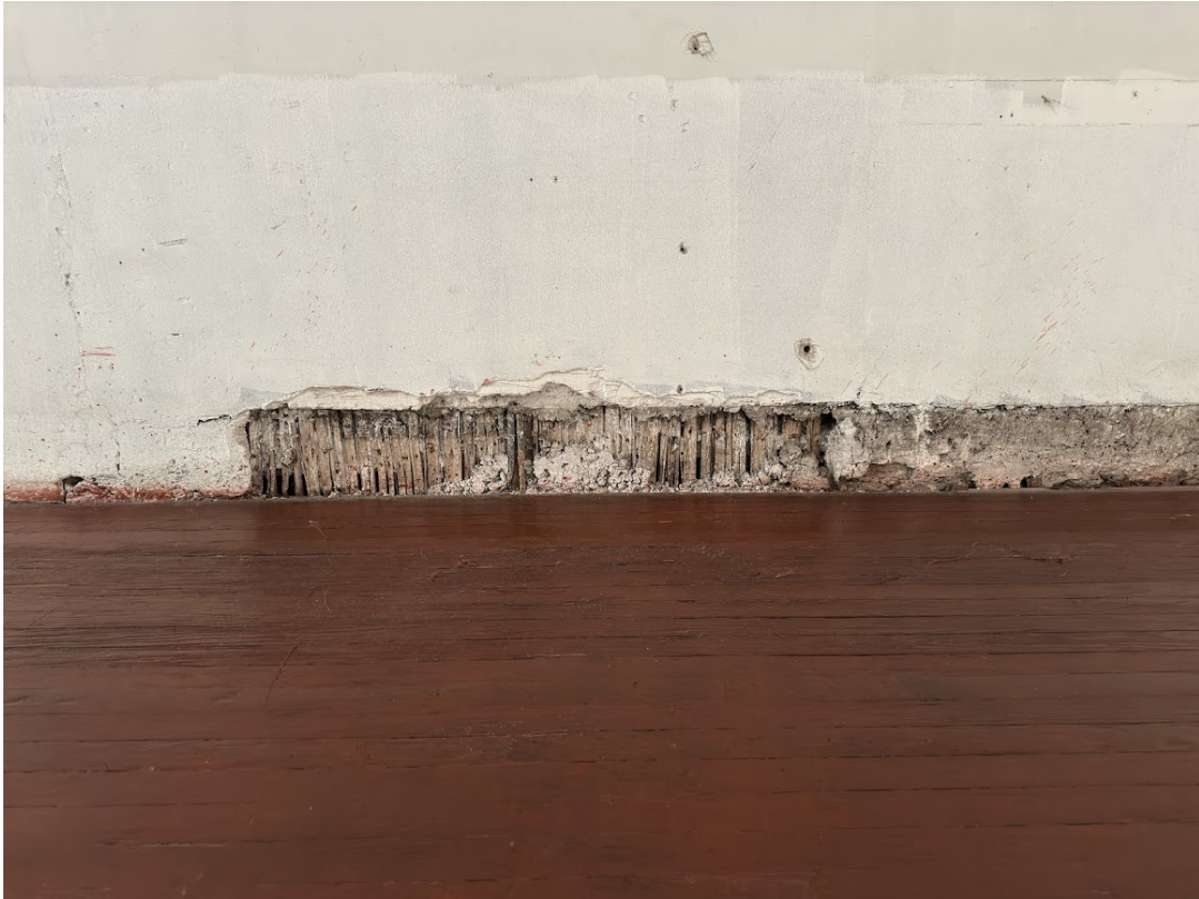
Imagen 118. Perdida del enfoscado del muro de quincha. Fuente: Fotografía del autor.
