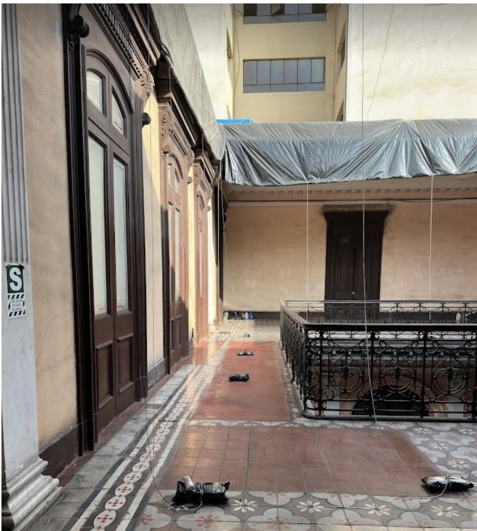
Imagen 114. Intervención incompatible del segundo nivel del zaguán. Fuente: Fotografía del autor.
