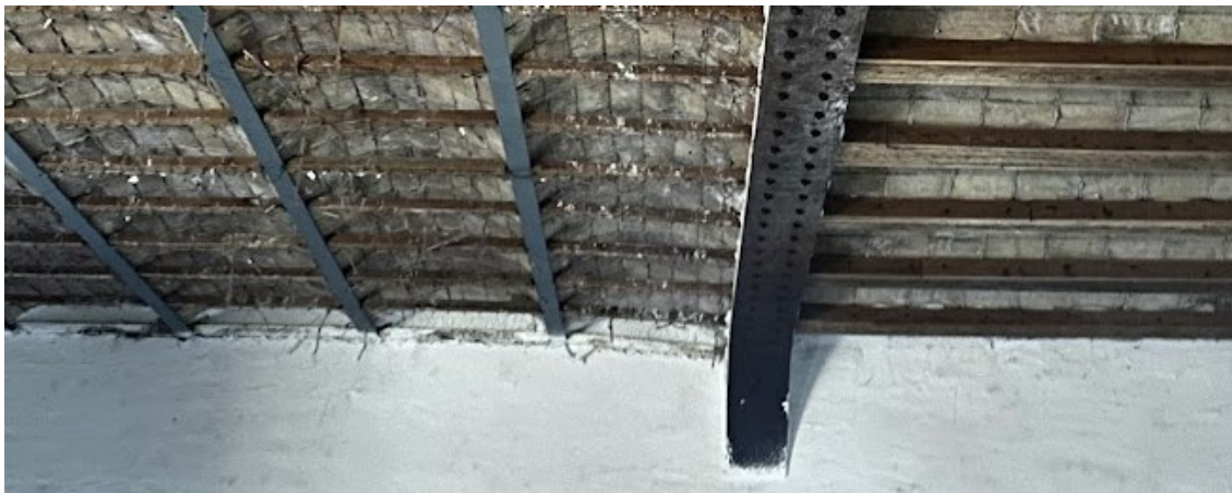
Imagen 27. Uso de forjado metálico y revoltones de ladrillo en Palau de Justicia de Valencia antes Real Casa de la Aduana de València. Forjado realizado en 1914 durante las obras de reforma para la instalación del Palacio de Justicia. Visita a obra 2024. Fuente: Fotografía propia.
