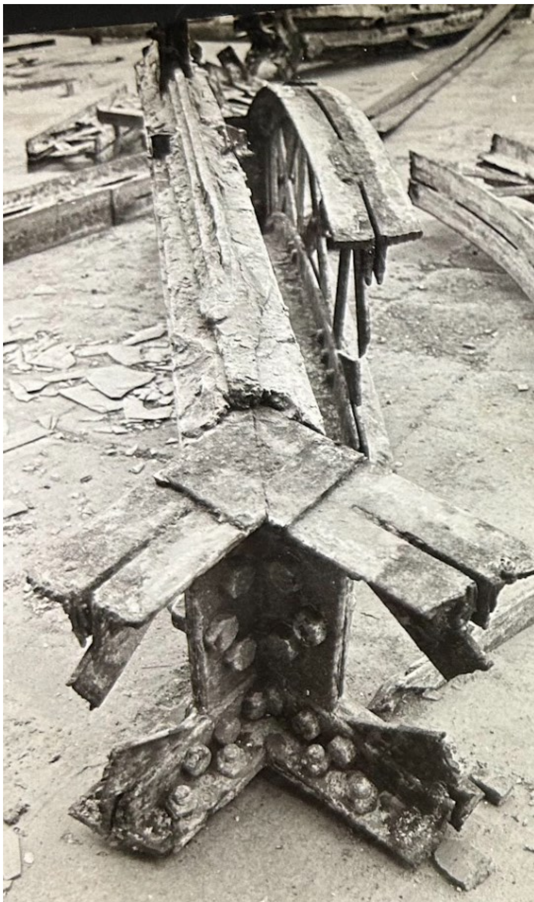
Imagen 59. Imagen de la sección de la cercha. Fuente: Ministerio de Cultura. (1974). Expediente de Retiro de Lucernarios del Edificio del Correo Central de Lima.
