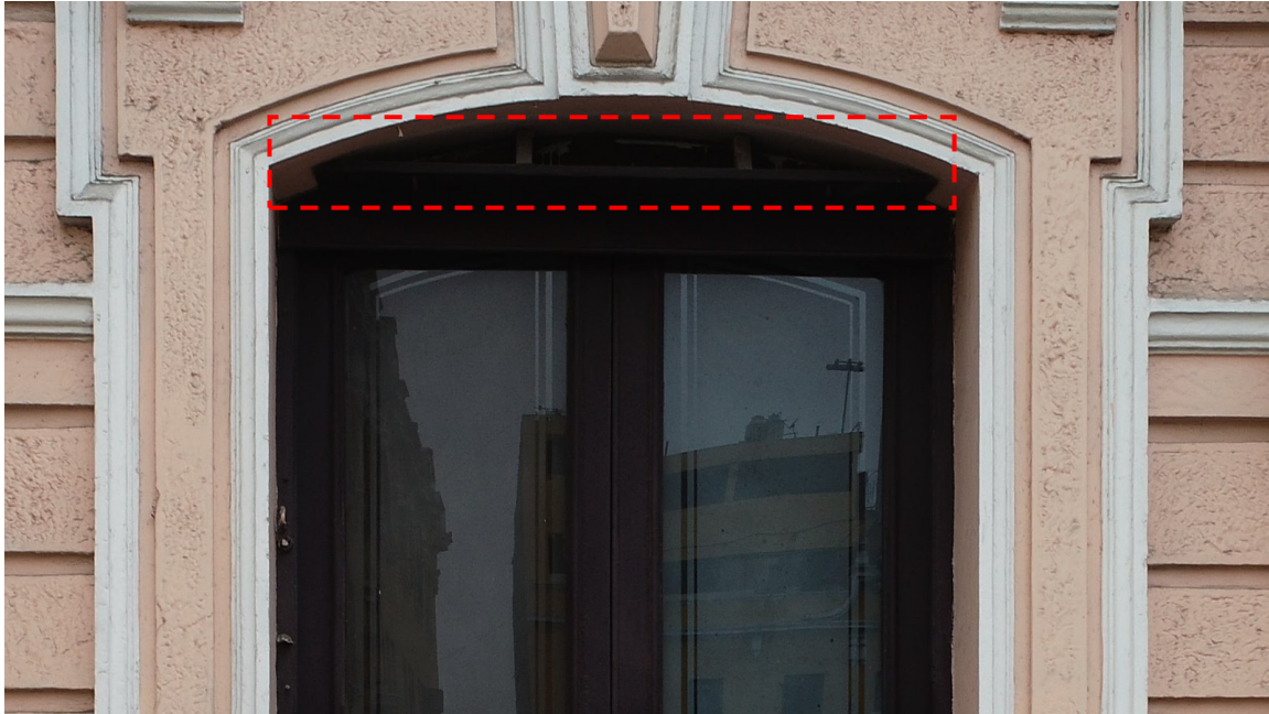
Imagen 99. Ennegrecimiento, xilófagos/ ampollas en marco y elementos de madera, fisuras en jambas de yeso, acabado incompatible en vidrios, elementos incompatibles.
